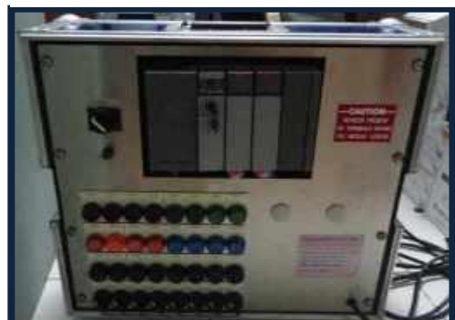
Allen Bradley SLC 5/03
